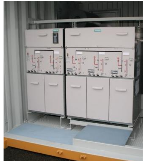
Gassisolert høyspent lastbryteranlegg med fordeling. (Type:Siemens)
